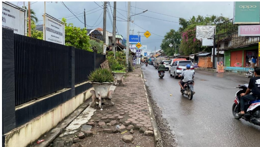
Gambar 4.16 Kondisi Jalur Pejalan Kaki yang Rusak
