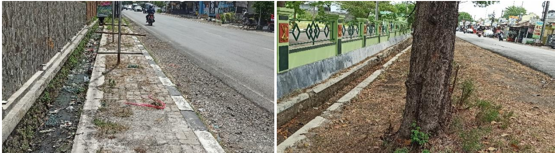
Kondisi Jaringan Drainase Primer Ruas Jalan Pilang Raya
